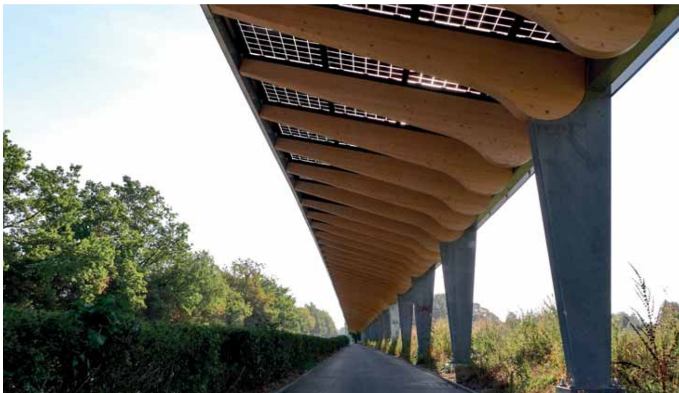
Abb. 1: Die SIG zusammen mit dem Staat Genf haben 2023 den ersten solarbetriebenen Radweg der Schweiz eröffnet. Auf einer Strecke von 210 m in Satigny/GE generiert die 163.8 kWp starke PV-Anlage 203'600 kWh/a CO 2 -freien Solarstrom.
