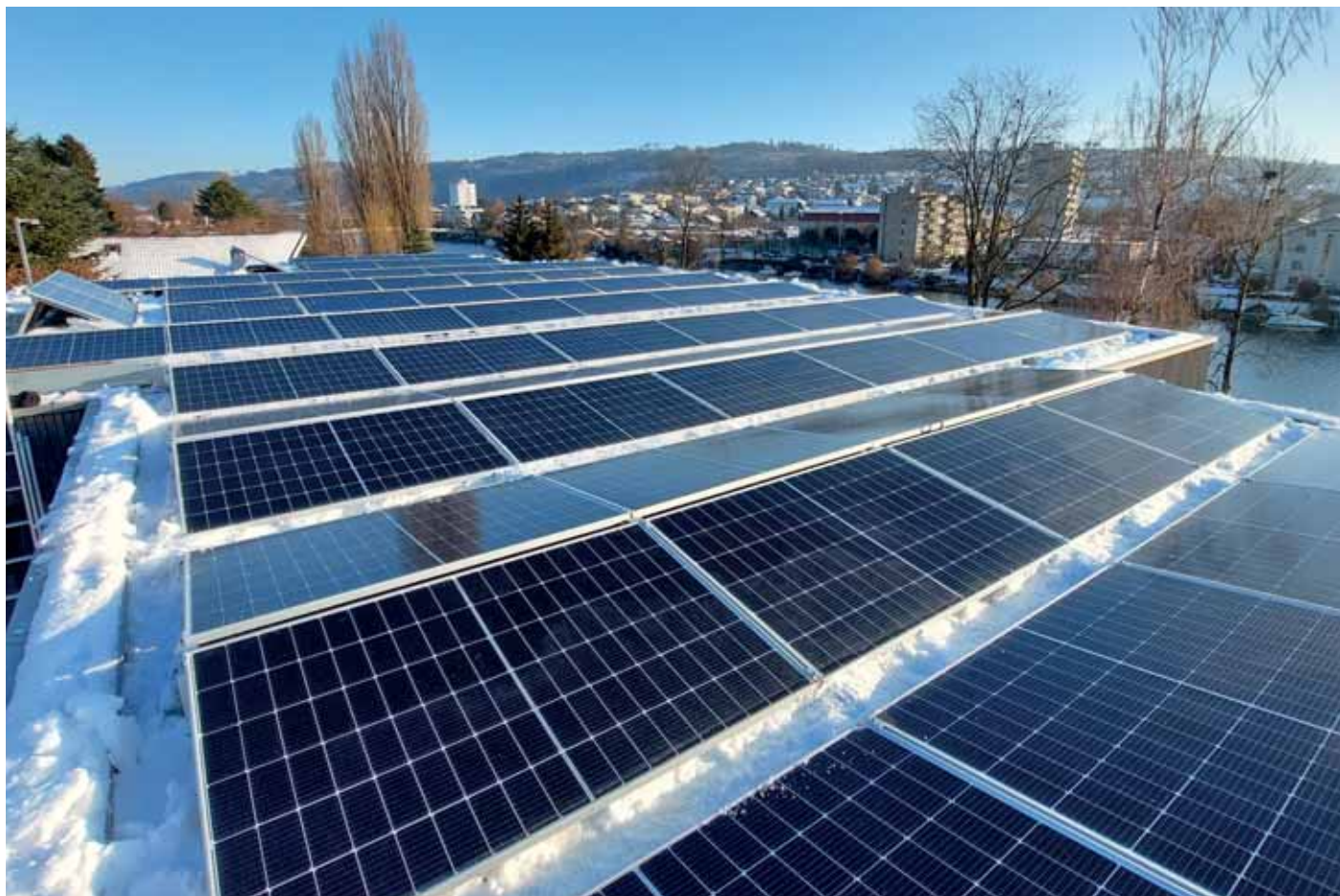
Abb. 2: Die Dachfläche und der Unterstand des Mehrfamilienhauses wurde mit 52 kWp starken Solarpaneelen ausgestattet, die jährlich 55'350 kWh Solarstrom erzeugen. Dies reicht, um den Eigenenergiebedarf von 25'120 kWh pro Jahr zu 220% decken.
